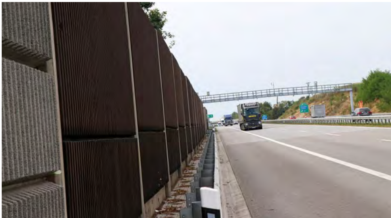
Obr. 4.8 Protihluková stěna eliminuje vliv rušení, zároveň ale zvyšuje bariérový efekt. V místech soustředěných migrací je proto nutné stěny doplnit dalšími opatřeními. (© Václav Hlaváč)
