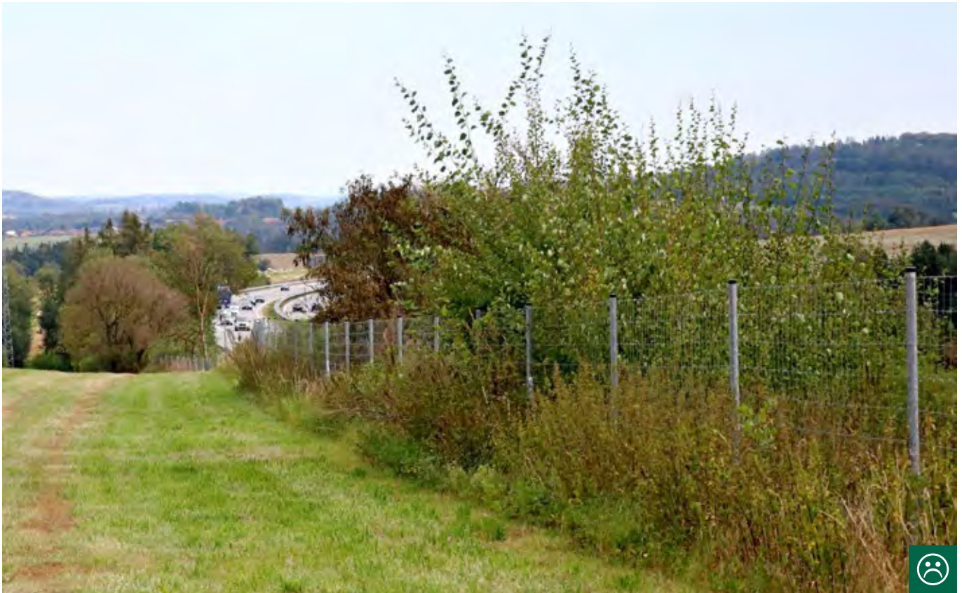
Obr. 10.52 Oplocení vedené po hraně zářezu desítky metrů od dálnice není možné pravidelně kontrolovat. Zeleň v zaplaceném pásu představuje navíc v okolní bezlesé krajině atraktivní biotop. Při poškození plotů např. zemědělskou technikou pak dochází k pronikání zvířat do zaplaceného prostoru. (© Václav Hlaváč)
