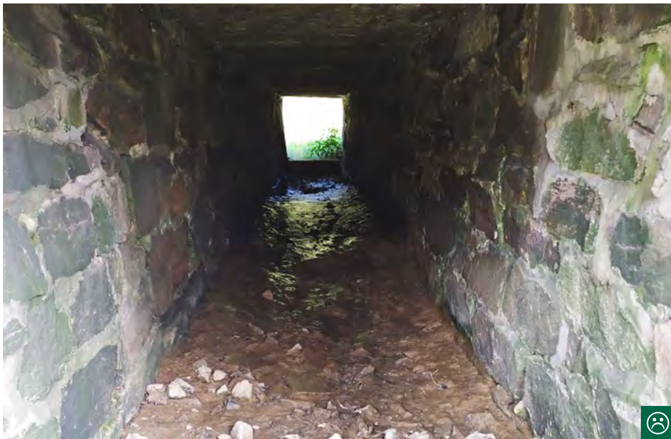
Obr. 10.33 Usazené splaveniny na dně rámového propustku vytvářejí vhodný substrát pro migraci obojživelníků, v tomto případě je však objekt pro tuto skupinu neprůchodný kvůli výškovému stupni na konci propustku. (© Václav Hlaváč)
