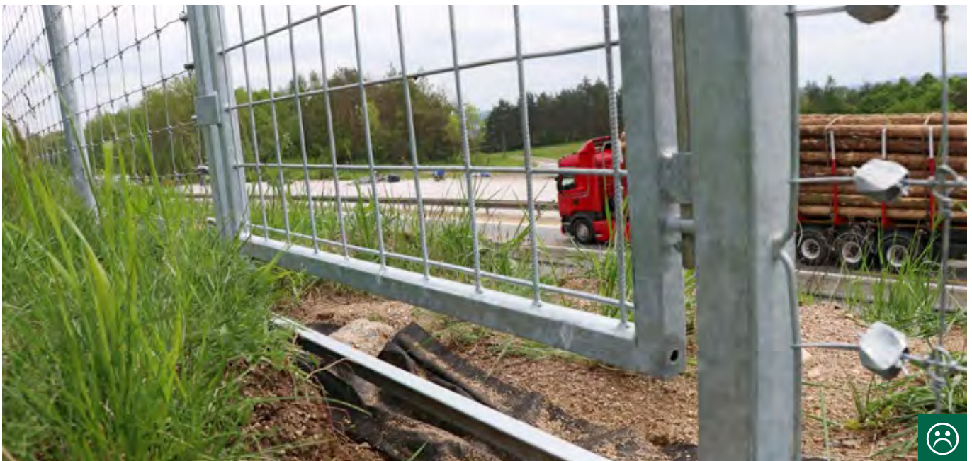
Obr. 10.46 Funkci oplocení často narušují nedostatky při konstrukci branek. Branky musí být konstruované tak, aby nemohly zůstat otevřené. Mezi brankou a terénem nesmí vznikat mezera větší než 5 cm. V tomto případě by bylo vhodné spodní rozpěru mezi brankovými sloupky posunout výše k brance a terén dosypat k této rozpěře. Nevhodná je také velikost ok. (© Václav Hlaváč)
