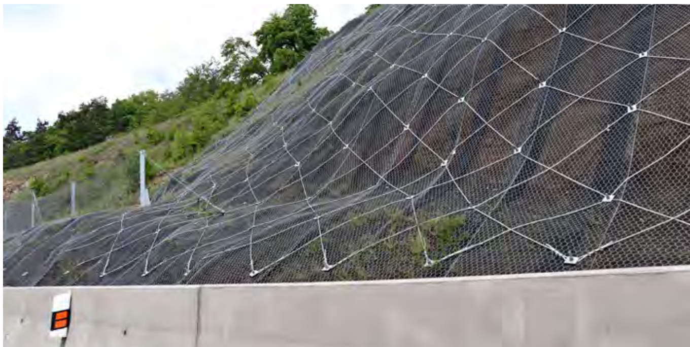
Obr. 9.10 Strmé svahy jsou zabezpečeny proti padajícím kamenům kotveným pletivem, zde navíc podloženým plastovou síťovou fólií. Tato opatření, používaná pro stabilizaci strmých svahů, vedou zároveň ke ztrátě přírodních stanovišť na okrajích silnice. Jejich použití by proto mělo být vždy omezeno na nezbytně nutný rozsah. Modernizace D1, Velké Meziříčí. (© Václav Hlaváč)
