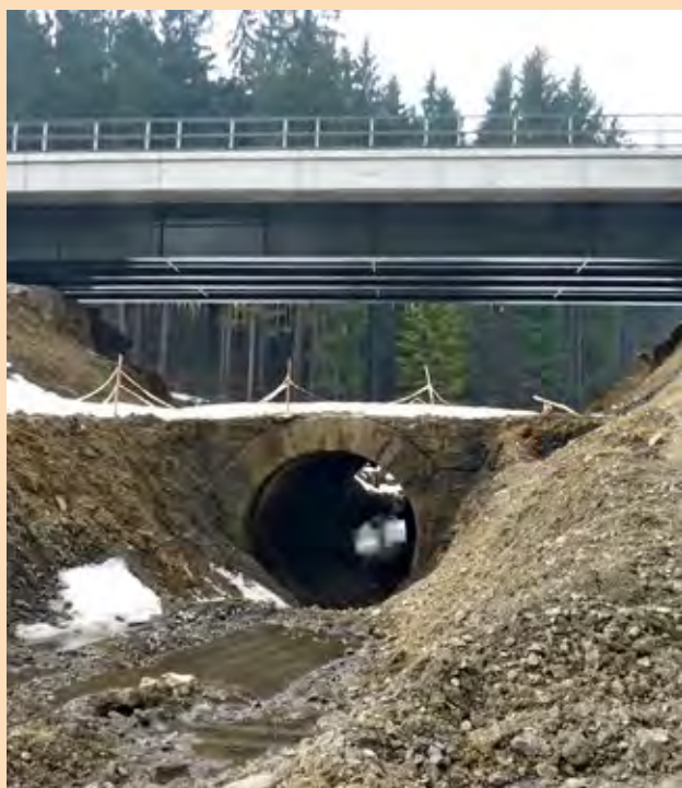
Obr. Výstavba podchodu pro velké savce pod železnicí v místě propustku na drobné místní vodoteči v obci Dolní Lomná v migračním koridoru propojujícím CHKO Beskydy s pohraničními polskými a slovenskými horami přes Jablunkovské mezihoří (stav 2012).
