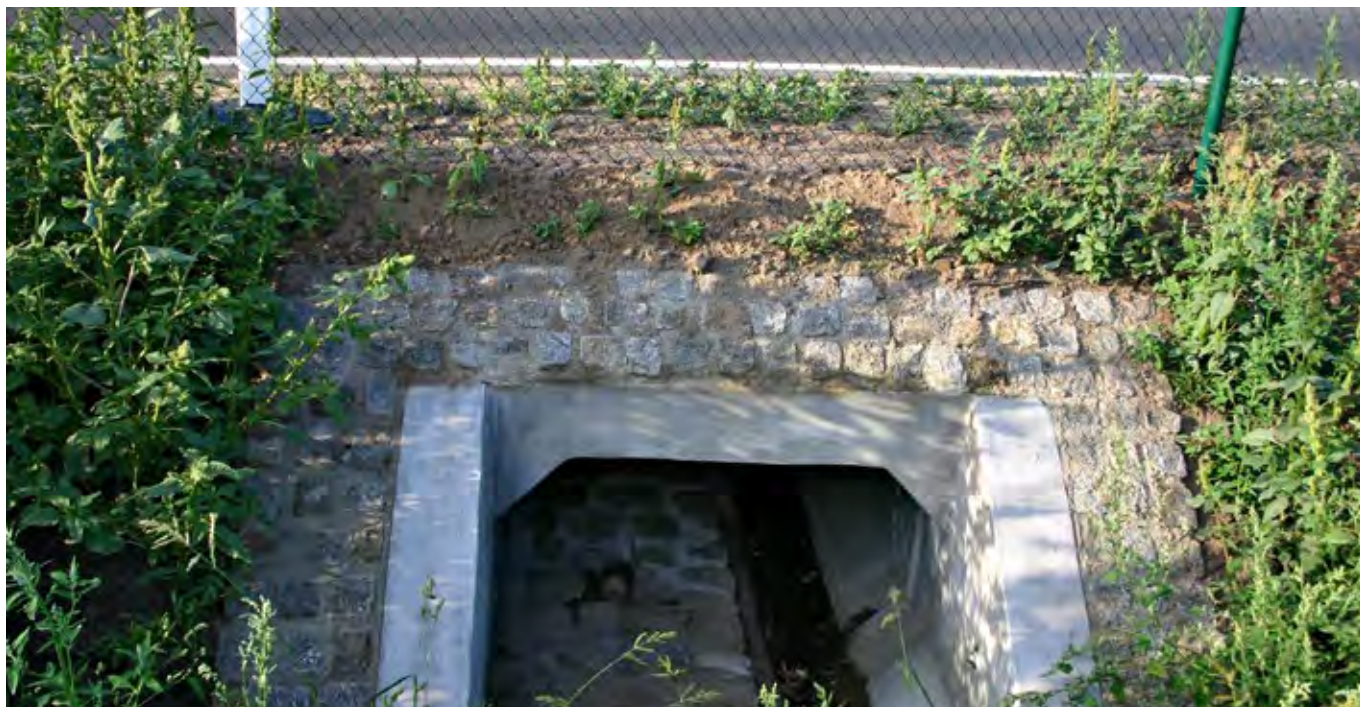
Obr. 9.3 Obdélníkové propustky vhodné jako průchod pro menší savce do velikosti lišky nebo jezevce jsou relativně snadným konstrukčním řešením u dopravní infrastruktury v rovinaté krajině. (© Lukáš Poledník)
