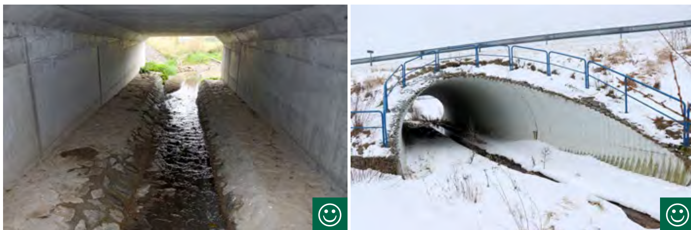
Obr. 10.34 Suché břehy po obou stranách toku v minimální šířce 0,5 m umožňují pohyb širokému spektru savců do velikosti lišky, jezevce či vydry, tyto mosty dokáží za příznivých podmínek využít také některé druhy netopýrů (např. netopýr vodní). (© Václav Hlaváč)
